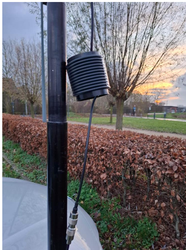
Figuur 8 — smoorspoel van de T2LT – Foto ON8ON
